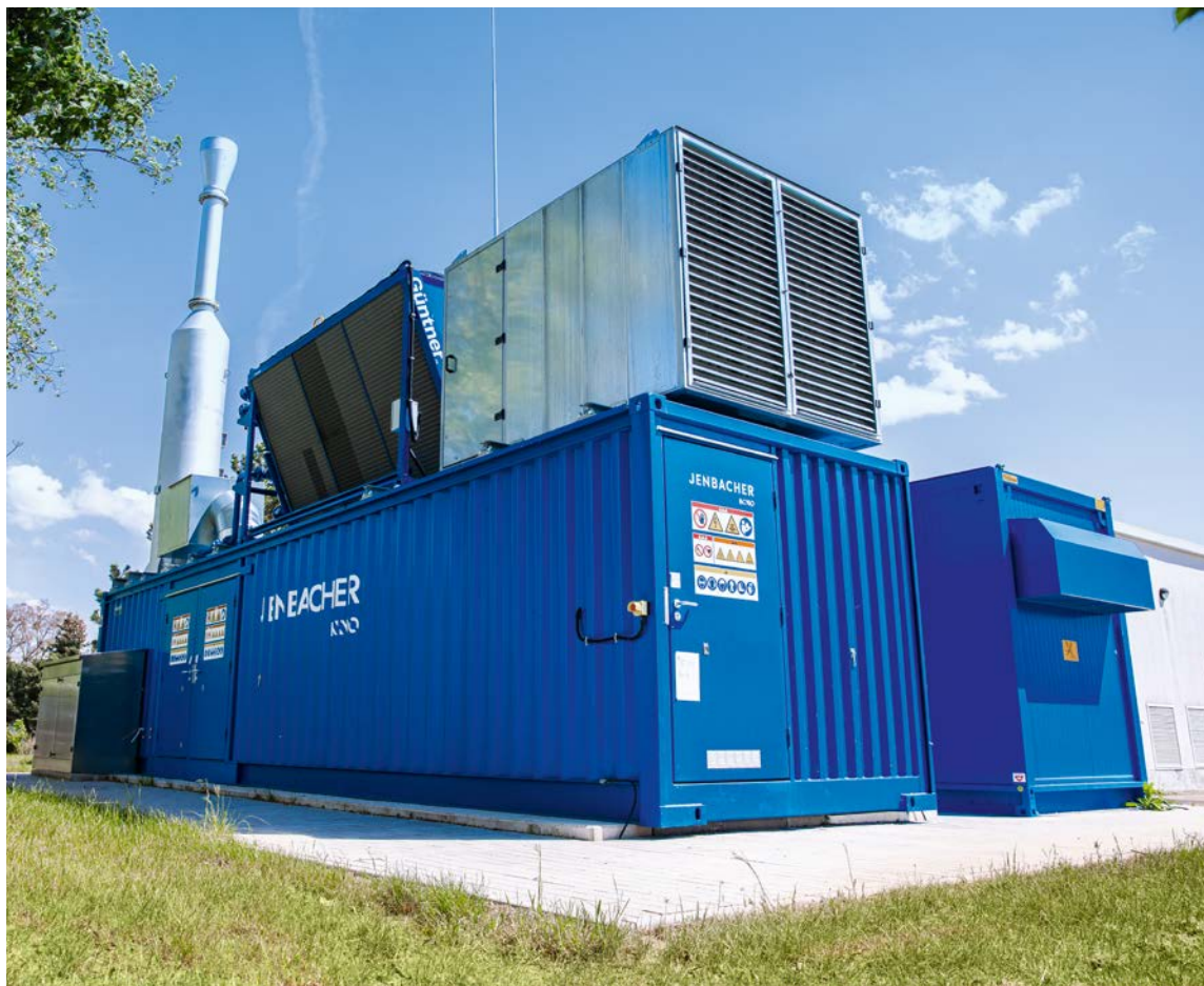
Die Netzersatzanlage am Standort Torgau-Ost.
