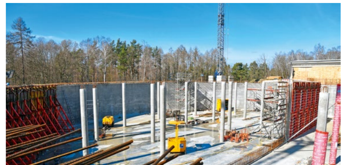
Neubau der Wasserkammer I des Hochbehälters Hohe Gieck mit einem Speichervolumen von 10.000 Kubikmetern.
