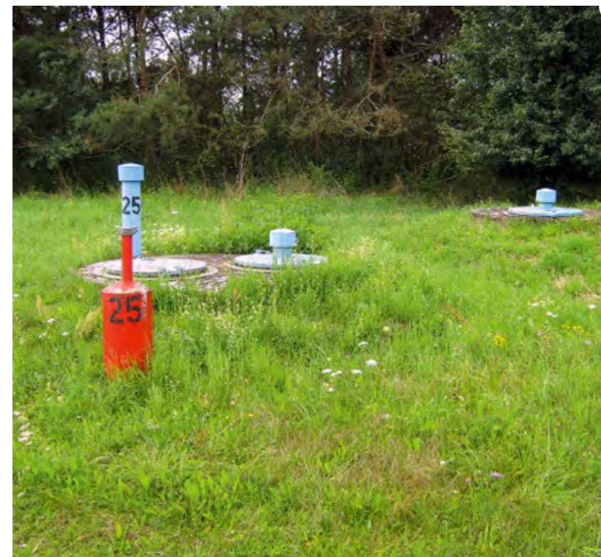
Insgesamt 25 solcher Brunnenbau-werke umfasst die Wasserfassung Döbern. Nach der technischen Umge-staltung dieser Brunnengalerie werden sieben neue Brunnen entstanden sein, die in ihrer Förderleistung der alten Galerie entsprechen.
